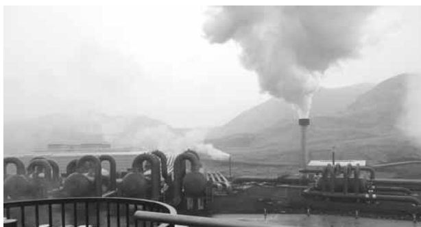
発電施設からは蒸気が噴き上がり続ける
