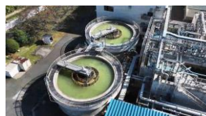
排水処理設備
