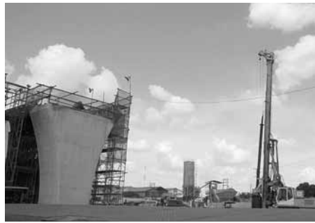
ダルエスサラーム市内にて渋滞解消のために現在建設中の立体交差橋
