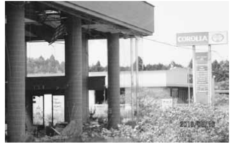
(写真⑧) 震災で壊れた店舗
