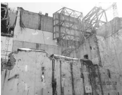
(写真⑥) 三号機建屋側面
