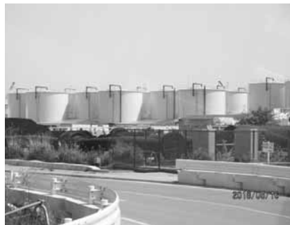
(写真③) 汚染水を保管するタンク
